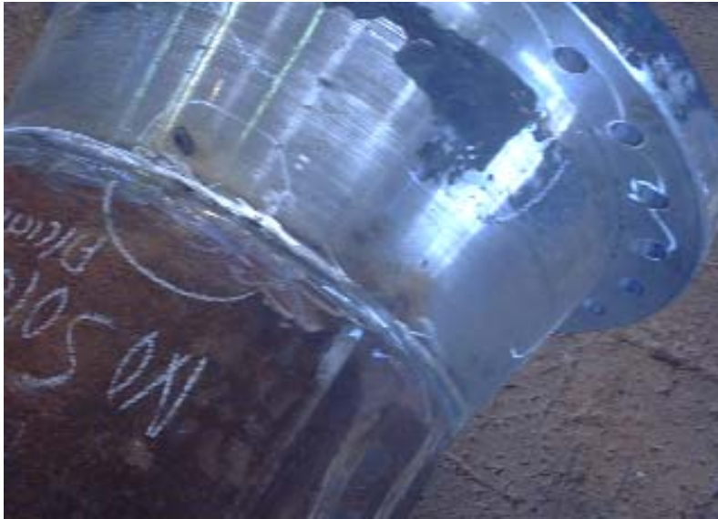
Figura.3.28. cavidades y presencia de poros en las Bridas.
